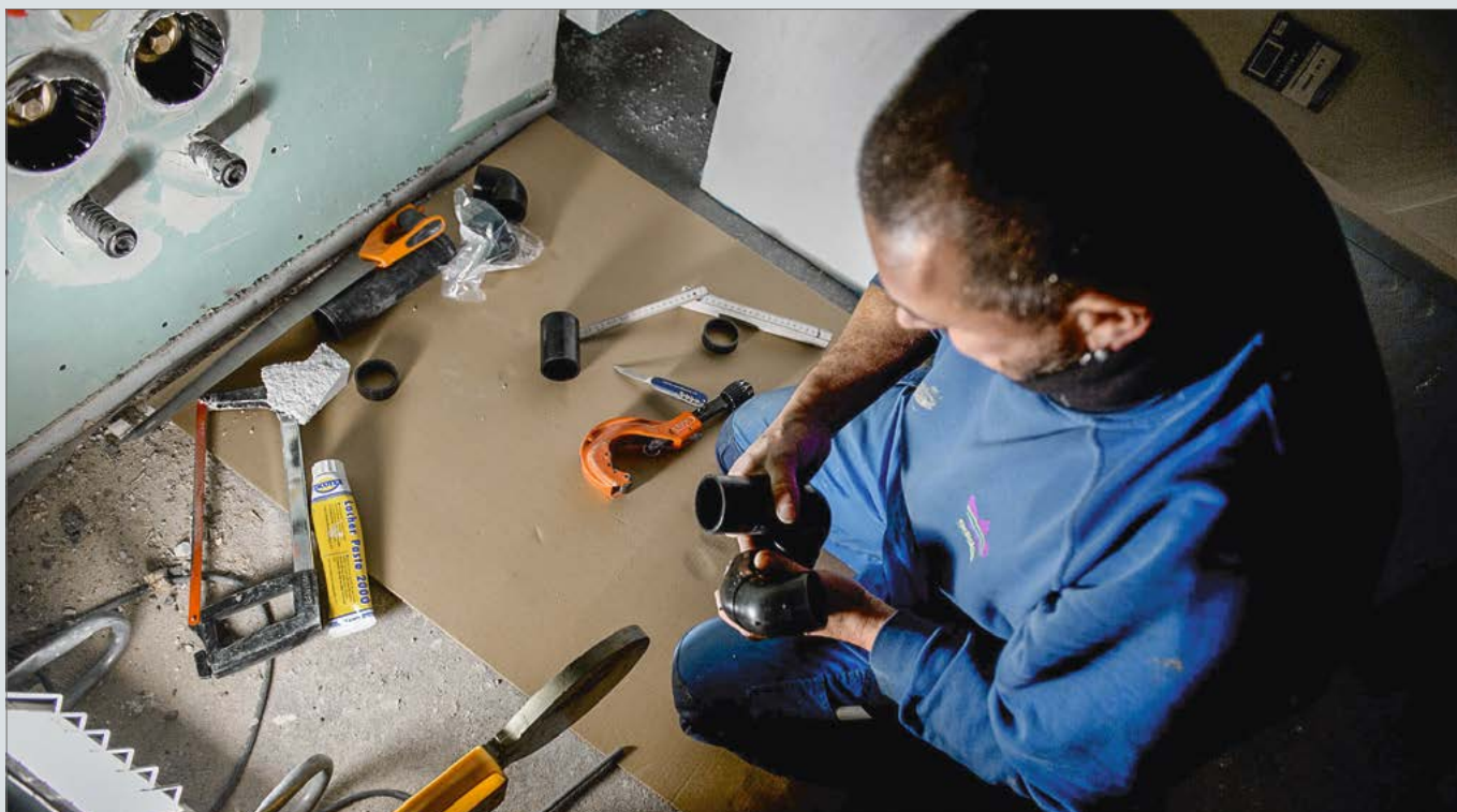
Eseguire installazioni domestiche per l'acqua potabile è un compito di grande responsabilità.
